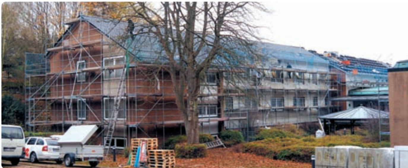
Wird komplett erneuert: Das 57 Jahre alte Betonziegel-Dach von Haus 1 der Sportschule.
