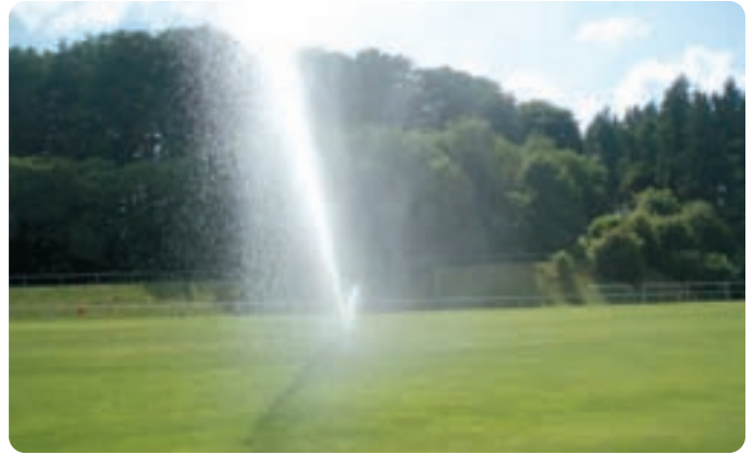
Mit der Versenkberegnung ist eine schlagkräftige Bewässerung des Sportplatzes möglich.
