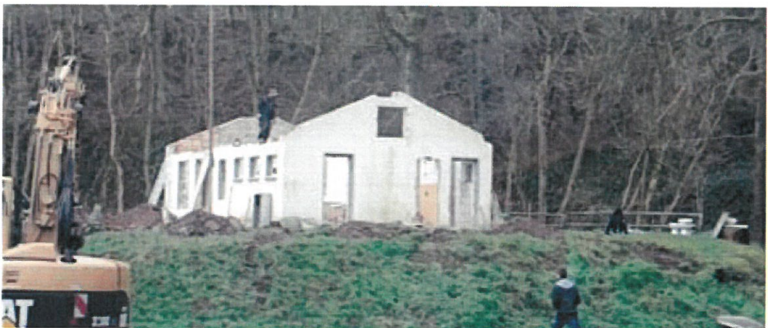
Abriss des alten Sportheims, welches 1964 auf einem extra „aufgeschütteten Hügel“ erbaut wurde.
