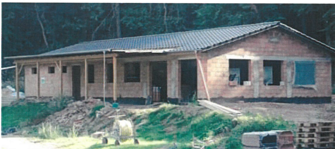
Der Rohbau steht auch auf dem überschwemmungssicheren „Hügel“ des Forstbachs im Hooptal
